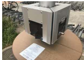
ソーラー外灯による充電設備 (東京都立川市)
