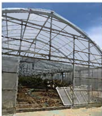
ハウスの出入口、天窓、谷間換気部の被害が大きい。
