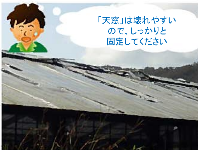
天窓の破壊(石垣市)
