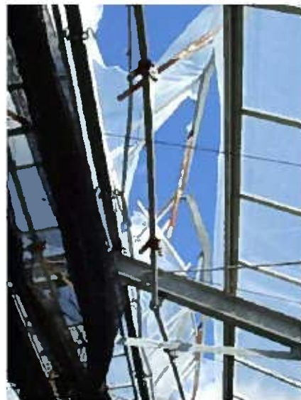
天窓の破壊(豊見城市)
