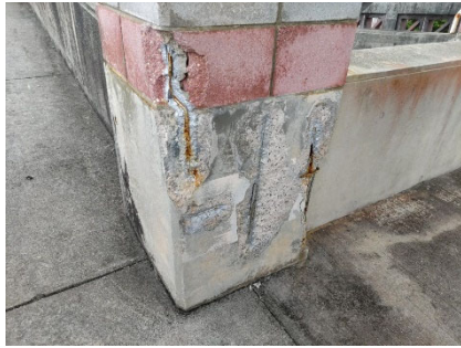
現庁舎本館 スロープ柱 (コンクリート剥離)
