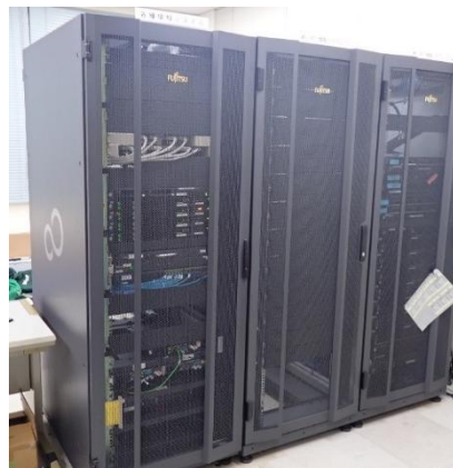
統一河川情報装置更新(ダム統管)
