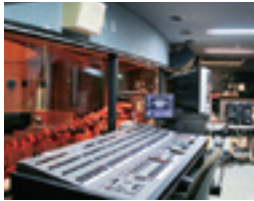
音響・照明・操作室
