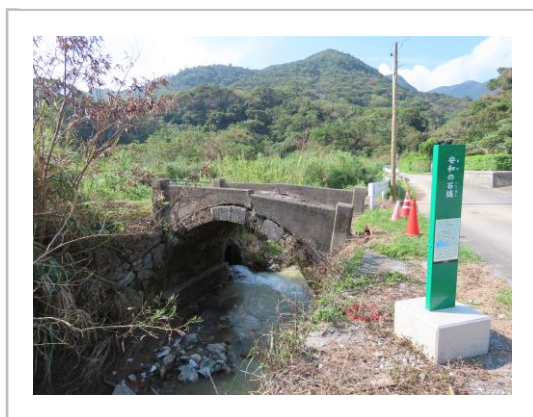
石橋の被害 2023/8/6 台風6号
