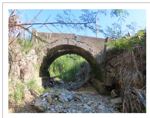
石橋の左岸側基礎が沈下した被害状況
