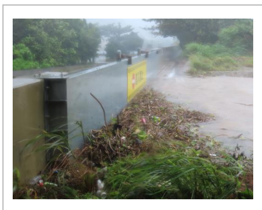
安和公民館前の防潮扉にぶつかる高潮
