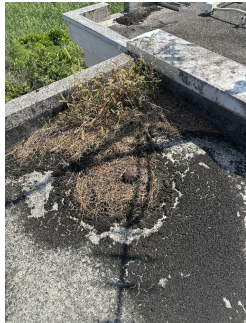
■今回工事でストレーナ更新
