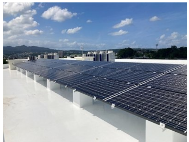
R階 太陽光発電設備
