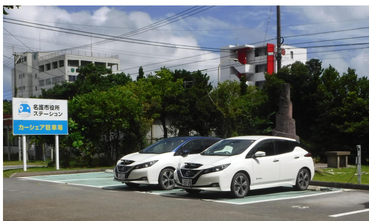
本庁舎の充電設備とEV公用車
