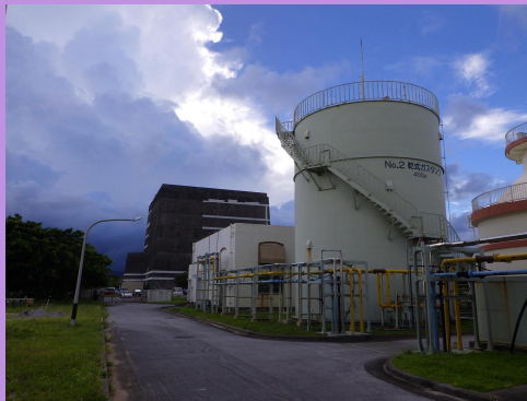
消化ガス発電設備
