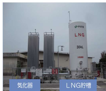
LNGサテライト施設
