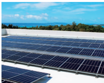
みらい2号館屋上(太陽光発電)
