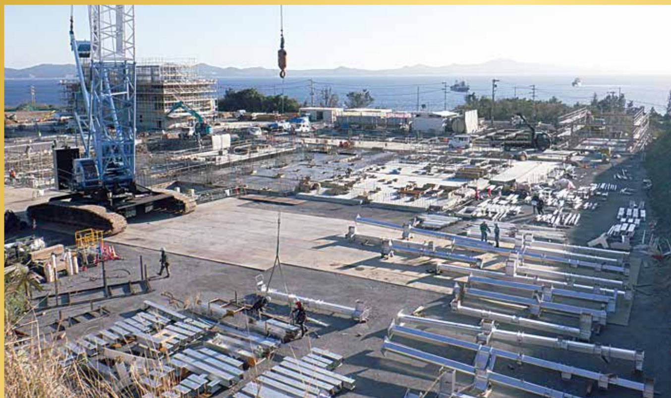
名護市新設廃棄物処理施設建設工事現場(安和区)令和5年12月8日現在 長山正邦議員提供
